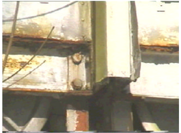
Rost am Meridiankreis-Dach
